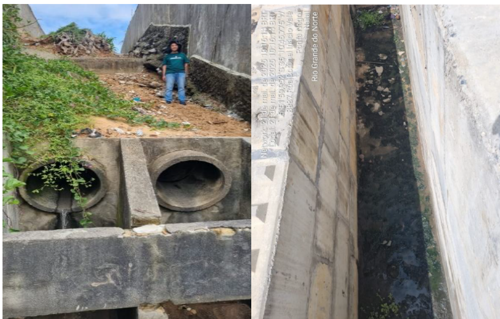
Figuras 3 e 4 – Galerias que desaguam no D1, com presença de esgotos clandestinos, D2 com lixo e água estagnada.
