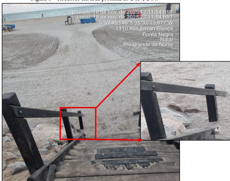
Figura 8 – Roedores em área próxima ao D13 e D14.
