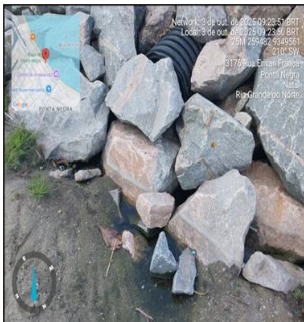
Figura 6 – D15 com indícios de lançamento de esgoto clandestino em seu interior.
